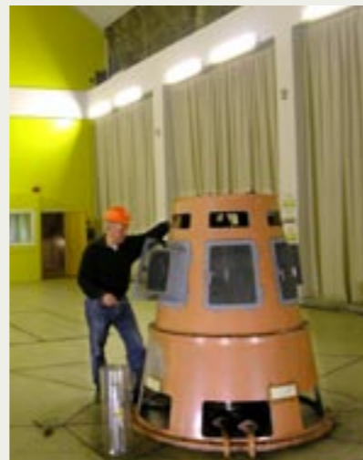
Maskinalen i Håen kraftstasjon Foto: Tore Wuttudal
