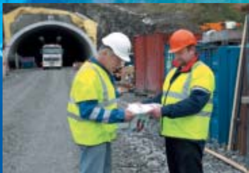
Montasjeleder Lars Lefstad og prosjektleder Per Espnes fra TrønderEnergi under planleggingen av trase for høyspentkabel inn mot tunnelen i bakgrunnen.
